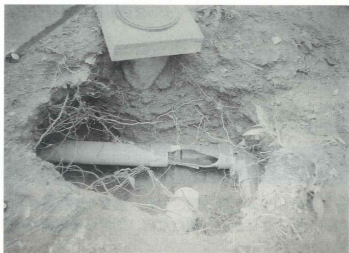
締め切り運転による漏水事故
